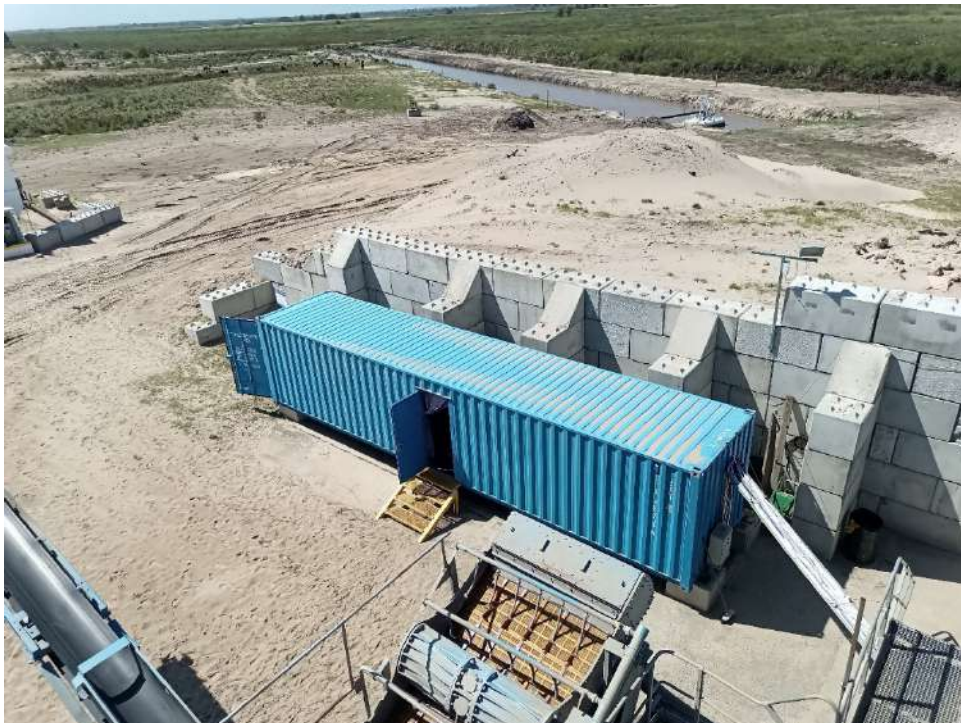
Vista de parte de la planta de lavado, la pileta de recirculación de agua en desarrollo y el sector del estero lindero al fondo.
