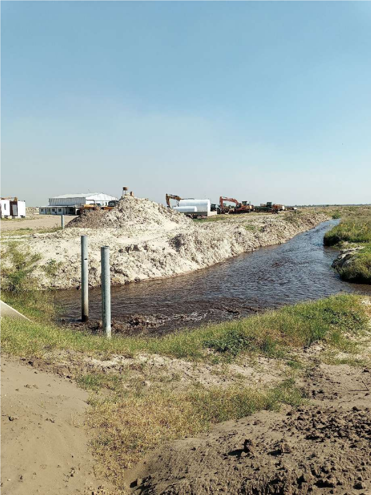
Salida del agua de rechazo de lavado y entrada en la laguna de recirculación.
