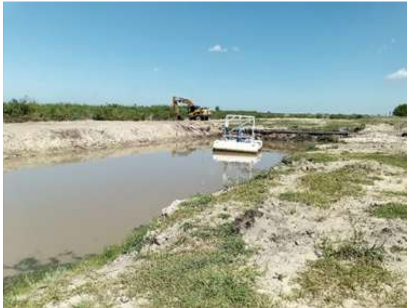
Figura V 31. Toma de agua en la pileta de recirculación.
