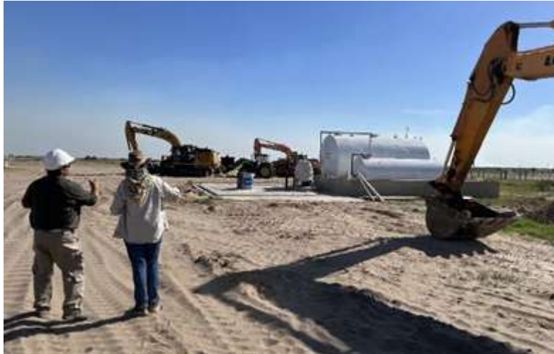
Figura V 62. Depósito de Combustibles.
