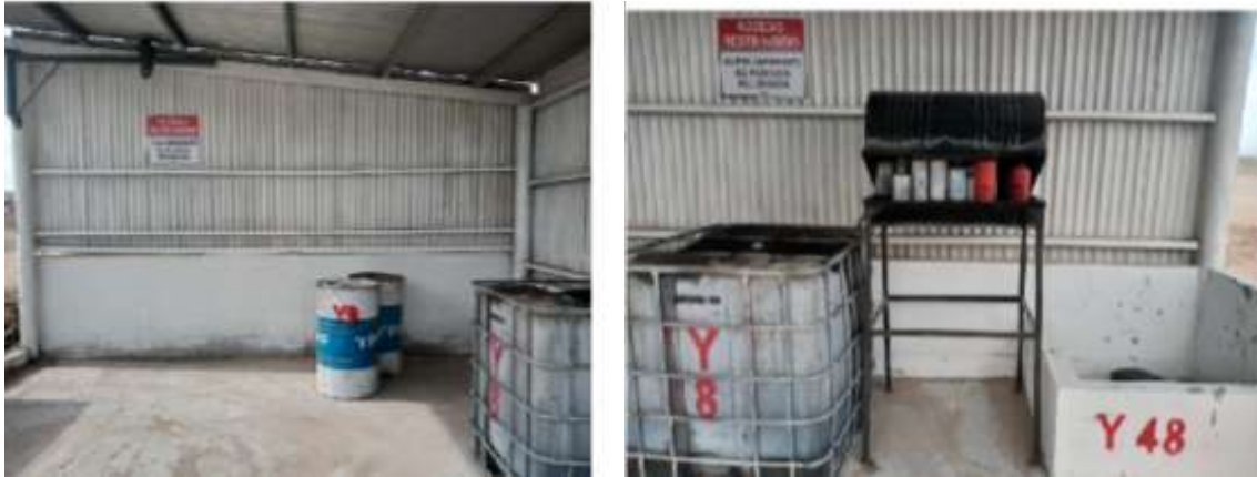
Figura V 63, Depósito de residuos peligrosos con contenedores aptos para cada tipo.
