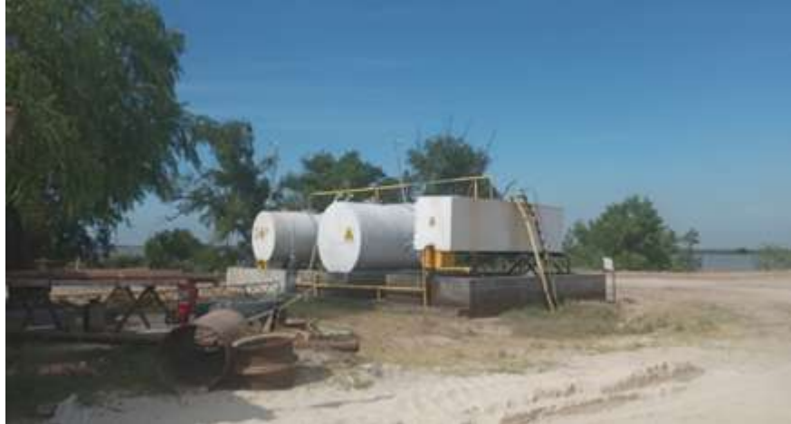
Figura V 75. Tanques de combustible con pileta antiderrame.
