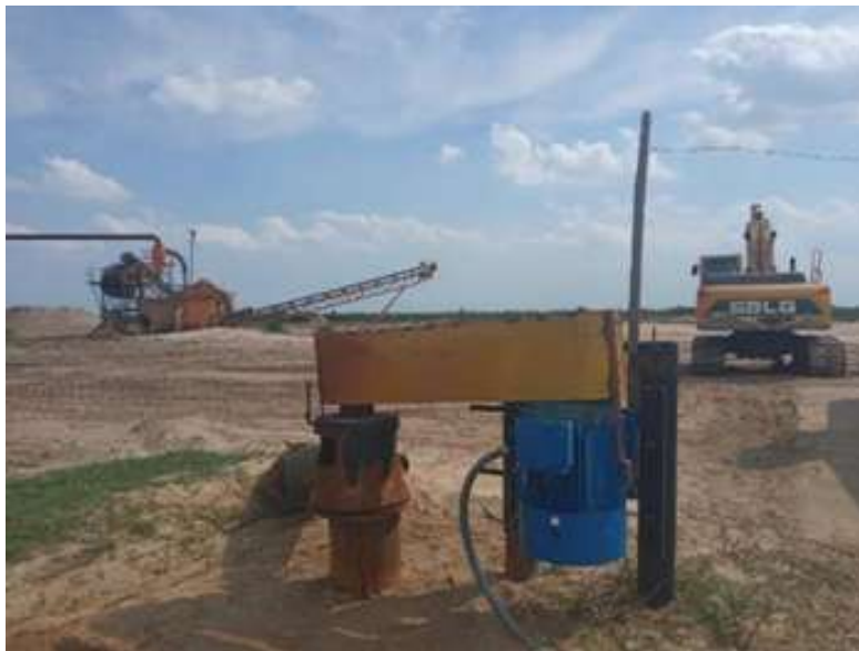
Figura V 46. Pozo de extracción de agua con bomba.
