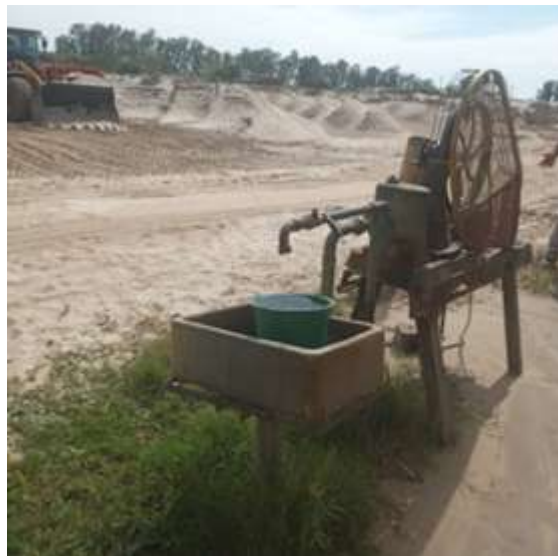
Figura V 72. Bomba de extracción de agua para uso sanitario.
