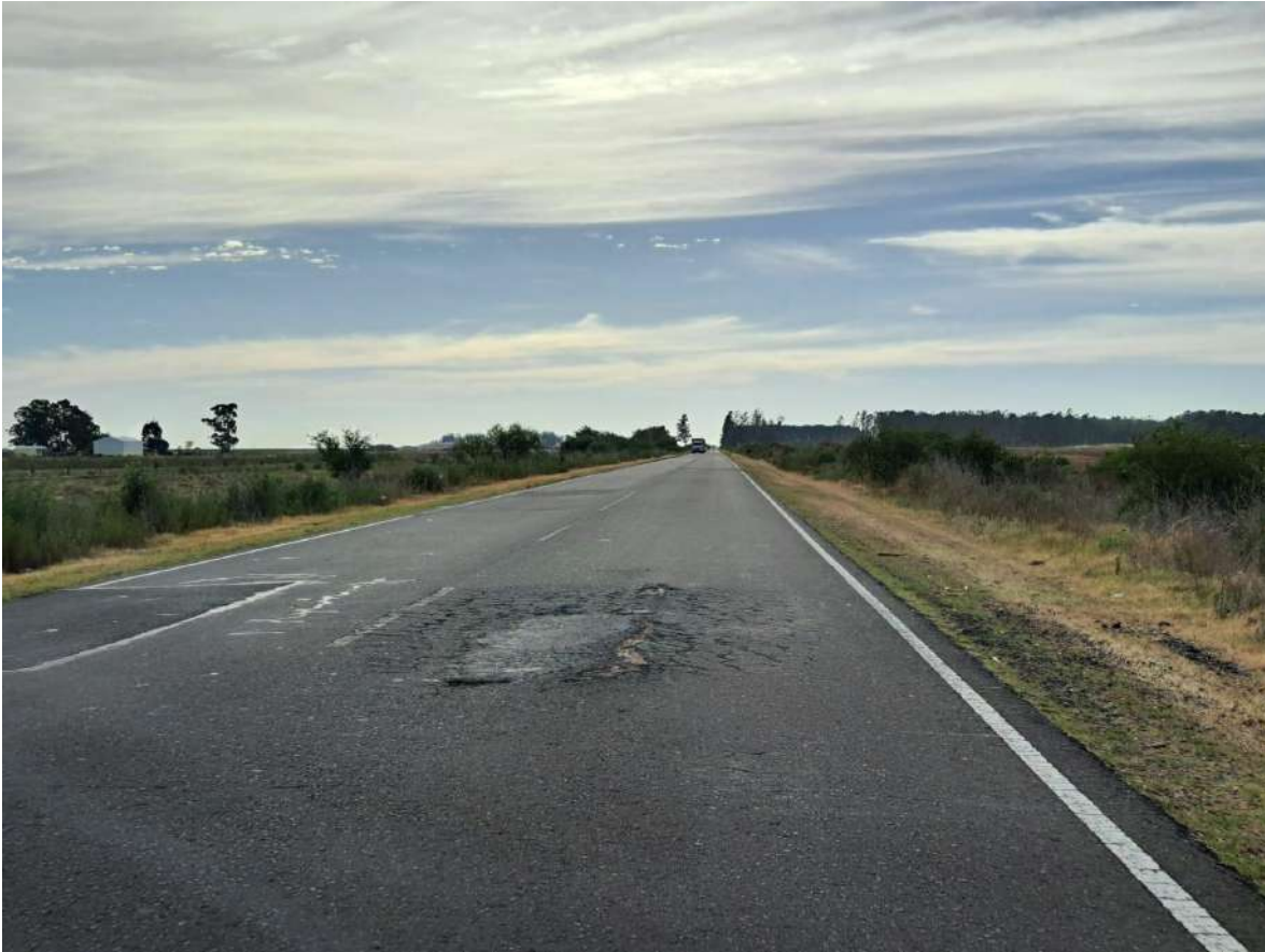
Figura IV 32. Deterioro en la calzada de la Ruta Provincial N°45, en mano de circulación Ibicuy hacia RN 12.
