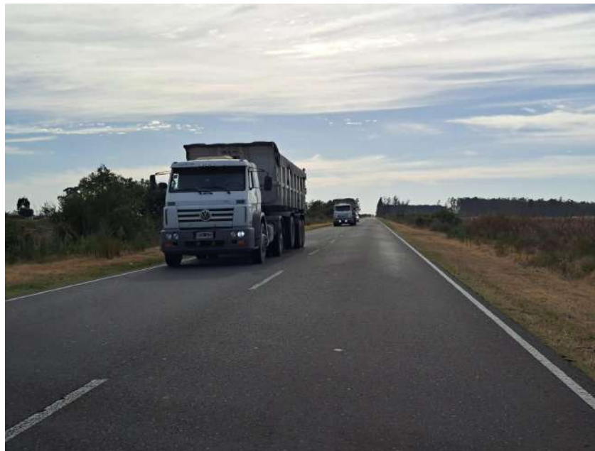
Figura VI 3. Vista de ahuellamiento en la calzada de la Ruta Provincial N°45, en mano de circulación Ibicuy hacia RN 12.
