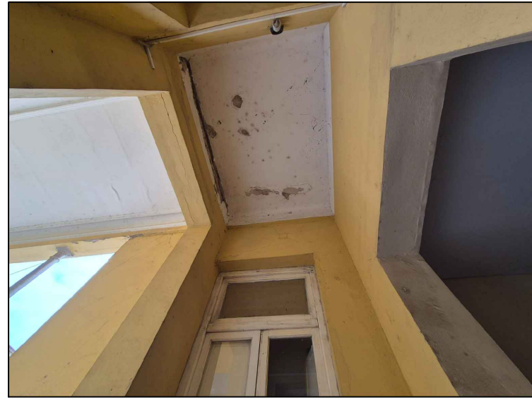
22- Paso Cielorraso crítico
