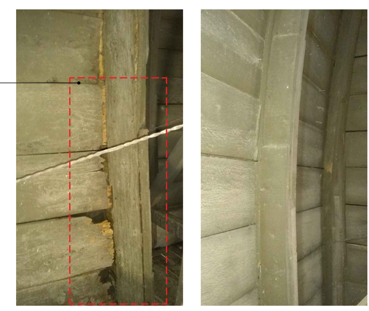
encuentro entre entablonado y cercha claramente deteriorado
